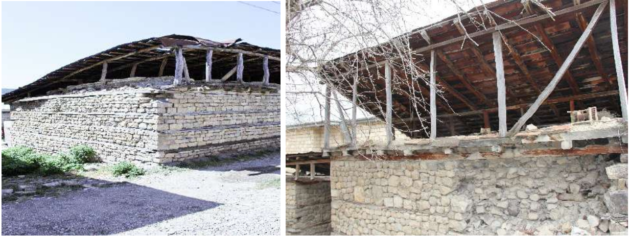
Şəkil 3.22 Çardaqların yarımaçiq və biryamaclı tikilmə səbəbi həm də tirlərə və tənəkə-dəmir lövhələrə qənaətlə bağlı idi
