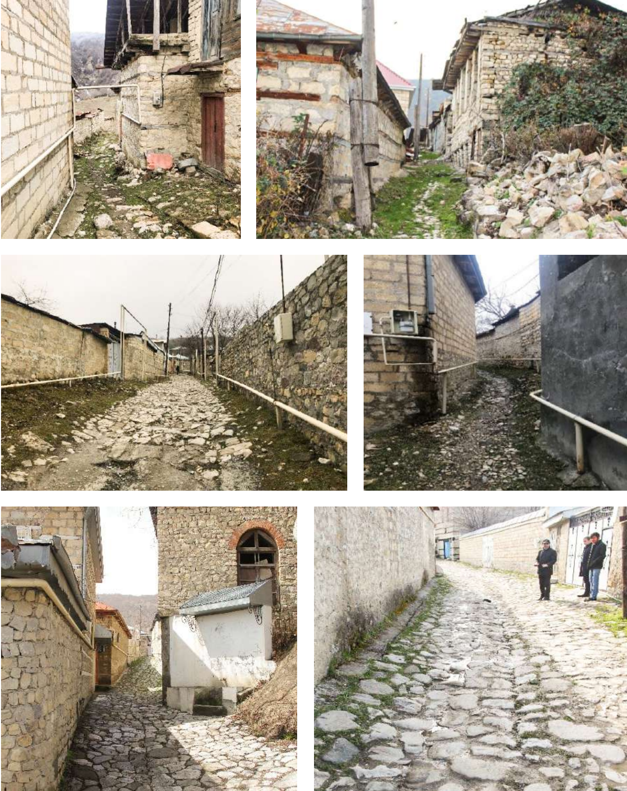
Şəkil 2.21 Basqalda yeni tövsiyələrə uyğun olaraq təmir ediləcək küçələrdən nümunələr
