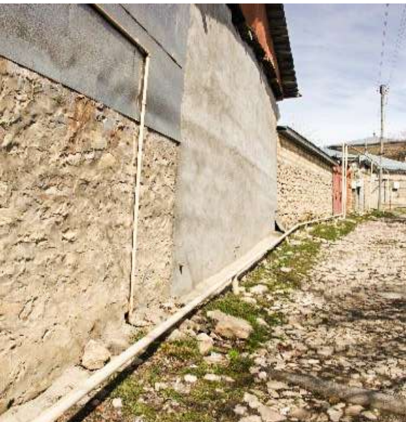
Şəkil 2.29 Demirçibazar küçəsindəki bu evin fasadı ənənəvi görüntünü pozur.
