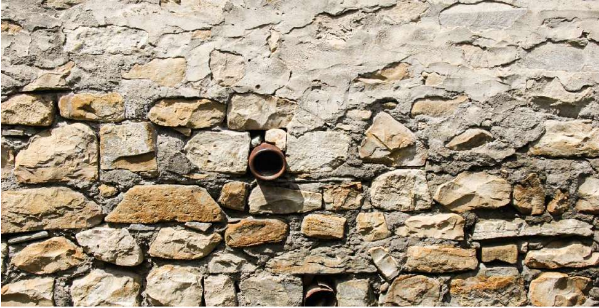
Şəkil 3.13 Boruların divarlardan küçəyə doğru navalça ilə çıxardılması və yağıntı sularının bu şəkildə divarlara zədə vermədən yönəldilməsi
