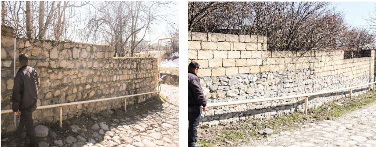
Şəkil 3.14 Yağıntı sularının axılması zamanı hasar divarlarının relyefə görə yerləşdirilməsinə diqqət etmək lazımdır
